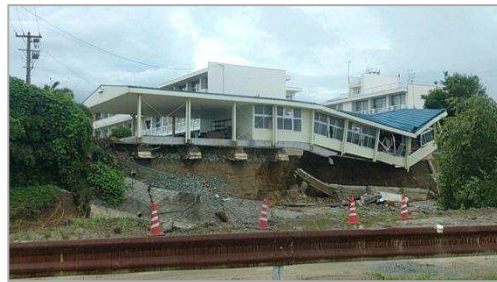
被害を受けた学校施設(朝倉)
